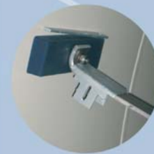
Maintien des chemins de câble, luminaires, échelles par des aimants
